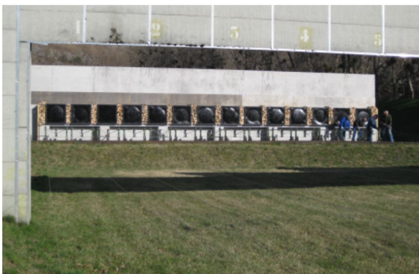
Abb. 30: 50m Jagdschiessanlage Rossboden, Chur, Einbau der KKF hinter der Scheibentransportanlage, Foto magma AG, 1.4.2009.
